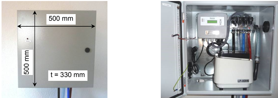
Abbildung 6: Steuerschrank aus Stahlblech links: Außenansicht mit den Hauptabmessungen rechts: Innenansicht mit Membranverdichter (Installationsbeispiel)
